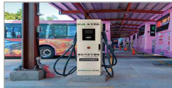
OCPP 120 kW充電機
