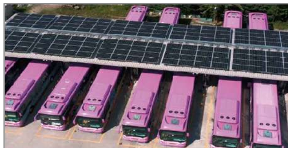
太陽能發電系統
